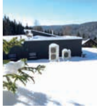
Rodinný dům v horské oblasti (nadmořská výška 750 metrů) vytápěný a chlazený tepelným čerpadlem s 300litrovým nerezovým bojlerem. Nové Hamry, Česká republika. Aquarea
