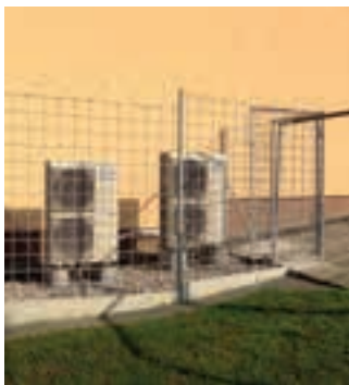
Centrální vytápění tuhými palivy pro 24 bytů předěláno na samostatné vytápění 4 bytových domů 8 tepelnými čerpadly. Soběčice, Česká republika. Aquarea
