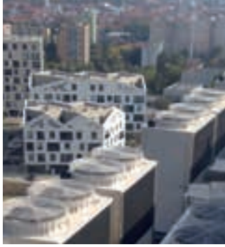
Instalace 21 systémů ECO G do medicínského univerzitního vědeckého parku MEDIPARK. Košice, Slovenská republika. ECO G. Aquarea
