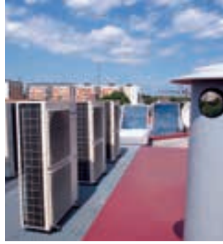
Výměna plynového systému vytápění za úspornější řešení postavené na kaskádě 8 tepelných čerpadel. Opava, Česká republika. Aquarea
